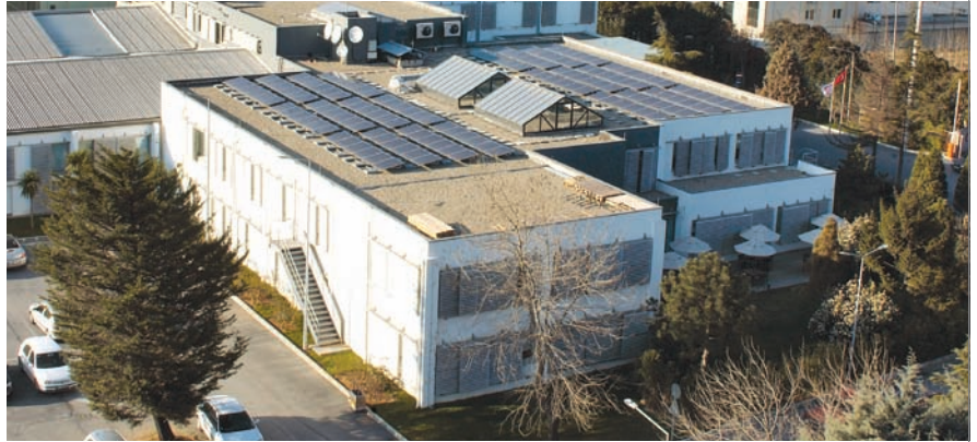
Bina teras çatısına yerleştirilmiş 18 kWp gücündeki mikromorf ince film fotovoltaik sistemin tasarımında bilgisayar simülasyonlarından faydalanılmış ve panel sıralarının birbirlerini gölgeleme sonucu üretim kaybının minimumda kalması sağlanmış
